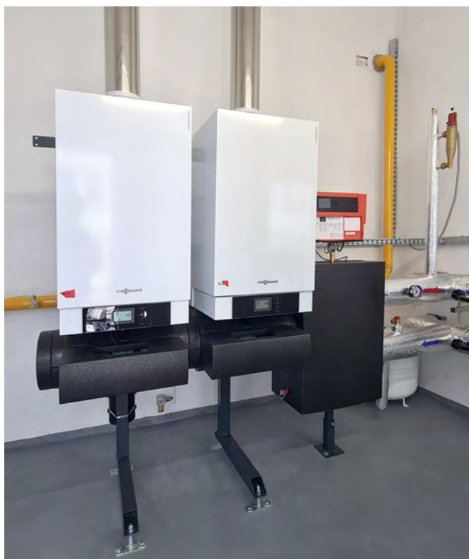
Gazowe kotły kondensacyjne w biurowcu Valvex S.A. (fot. Marek Bednarz)
