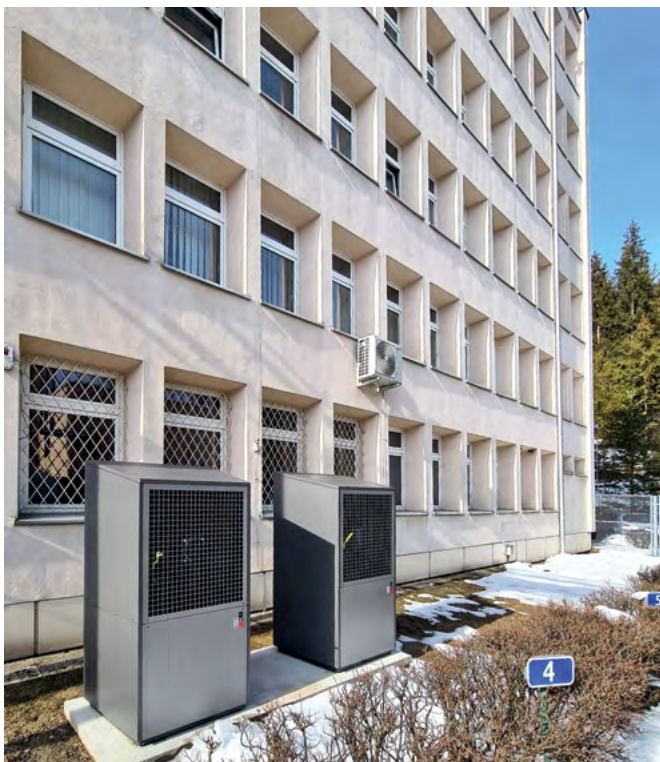
Pompy ciepła powietrze - woda przed biurowcem Valvex S.A. (fot. Marek Bednarz / Termoplan Sp. z o.o.)
